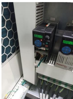
Ilustración 41. Estatus de falla.
