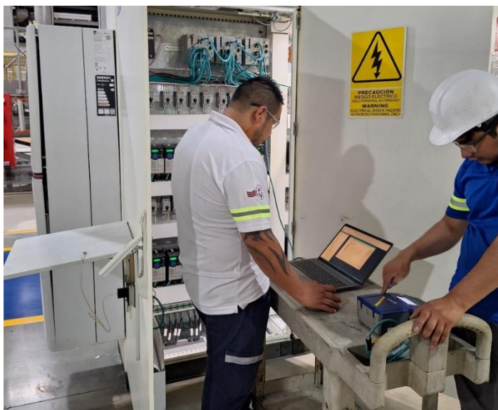
Ilustración 29. Programación de Switches
