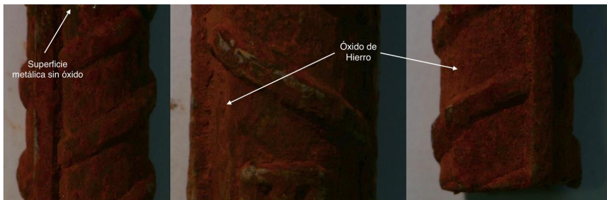
Figura 33. Varilla de acero corrugado sin recubrimiento en el día 20 de exposición.
