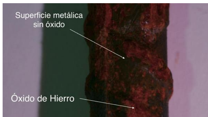
Figura 30. Varilla de acero corrugado sin recubrimiento en el día 7 de exposición.
