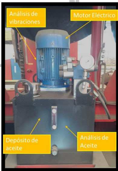
Figura 8. Motor Eléctrico 10 Hp y depósito de aceite (Giro REDROCK).
