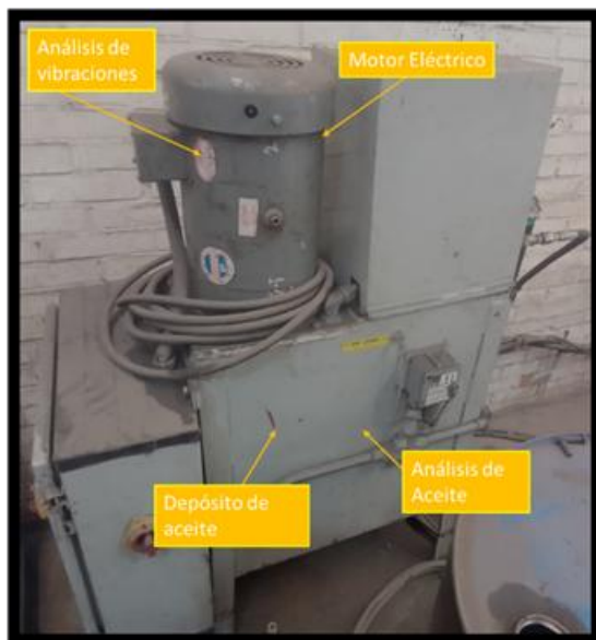
Figura 7. Motor Eléctrico 7.5 Hp y depósito de aceite- Remachadora Parker.
