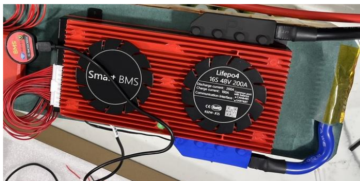
Ilustración 37: Evidencia de instalación de BMS en pack de batería. Elaboración propia.
