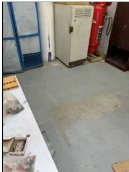
Figura 8. Muestra de daño a infraestructura. (Fuente; autoría propia)
