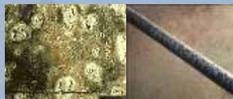
Fig. 5 En las figuras se observa la corrosión por picadura en una superficie plana y alrededor de una tubería
