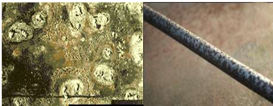
Fig. 28 Corrosión por picadura en una superficie plana y alrededor de una tubería.
