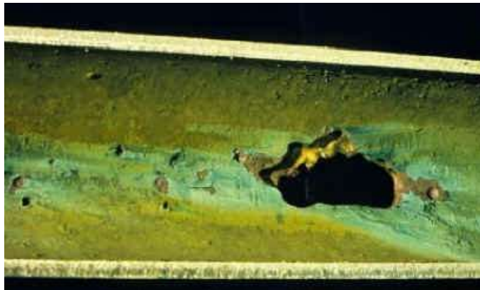
Fig. 26 deterioro de un material por la corrosión por Erosión.
