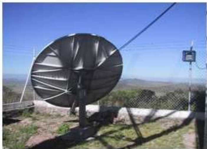
Foto 6.10.- Vista posterior de la antena.
