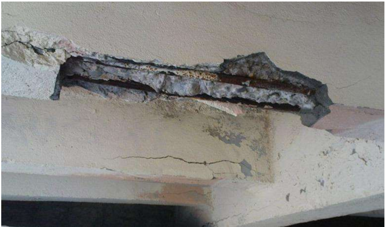
Fig. 1. Daño por desprendimiento del concreto reforzado debido a corrosión del acero por cloruros. Fuente: Concrete Preservation Technologies Ltd. (2017).
