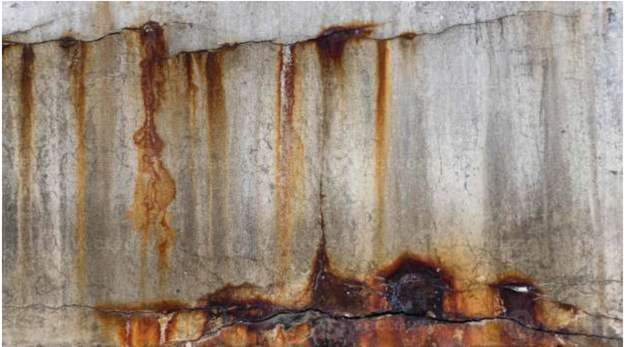
Fig. 2. Daño por desprendimiento (spalling) del concreto reforzado debido a corrosión del acero por cloruros. Fuente: Concrete Preservation Technologies Ltd. (2017).
