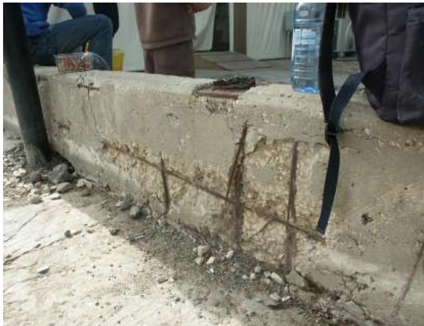
Fig. 5. Corrosión en concreto armado, Fuente: Kenny, A. (2008).
