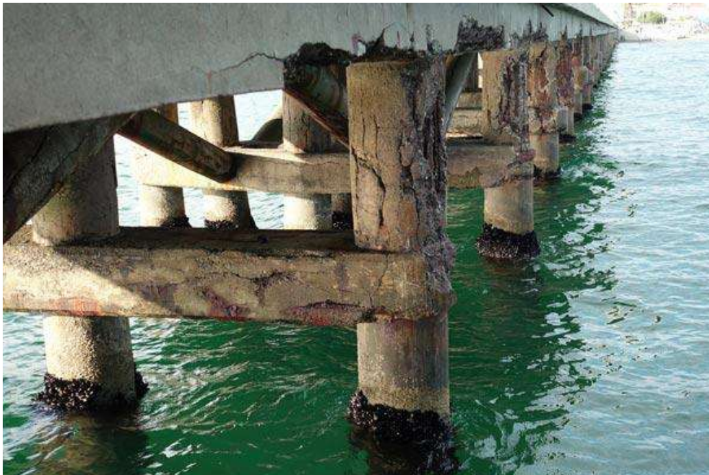
Fig. 6. Deterioro del concreto en ambientes agresivos. Fuente: Baricevic, A. et al. (2015).
