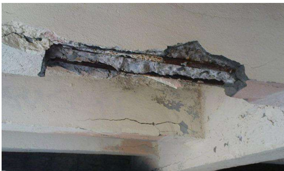
Fig. 7. Daño estructural por ingreso de cloruros. Fuente: Baricevic, A., et al. (2015).
