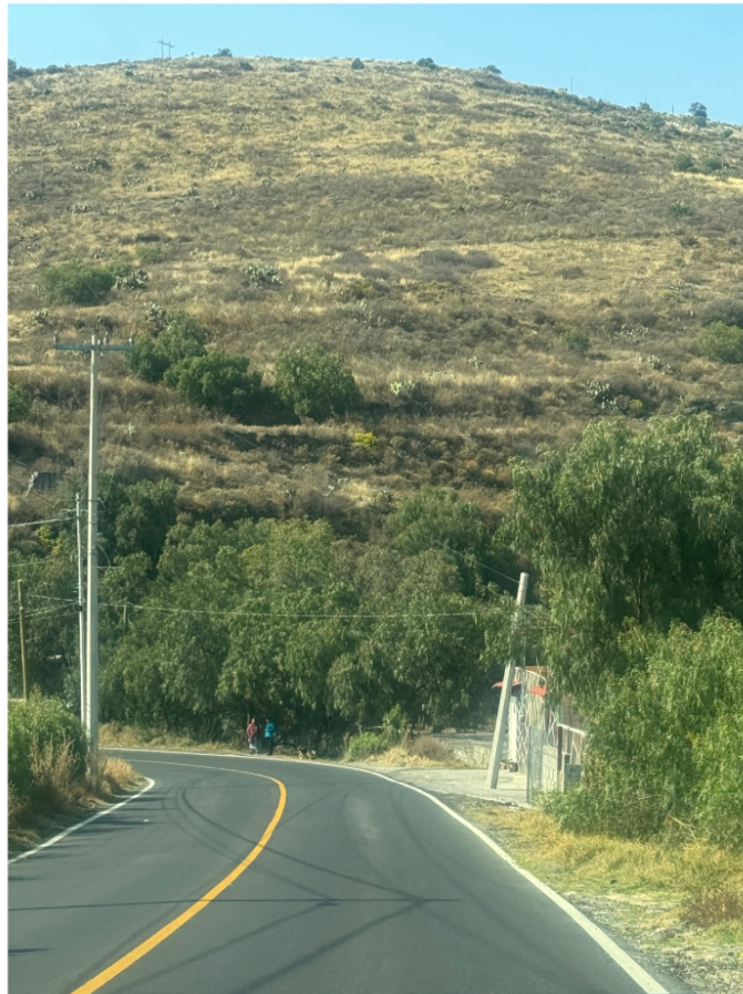
Ilustración 27. Carretera con ausencia de señales verticales y horizontales en el Barrio La Camelia
