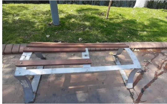
Figura 4.2: Bancas de diseño hostil y en estado deteriorado
