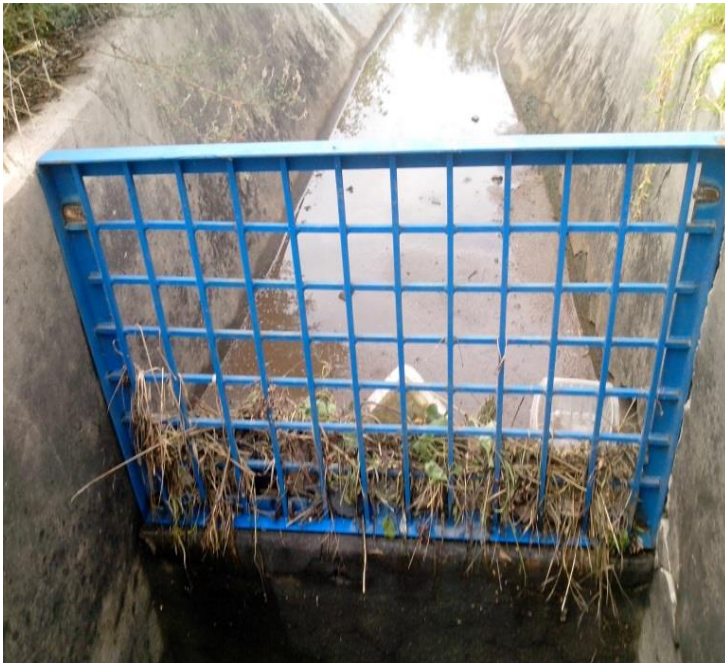
Foto que muestra una rejilla colocada en el canal para evitar que la basura obstruya el paso del agua. Esta rejilla junto con la última obra de revestimiento del canal fue hecha por CONAGUA, pero los usuarios cooperaron con una parte del monto de la obra en el 2015. Foto: Noé Téllez Pelcastre. 2015.
