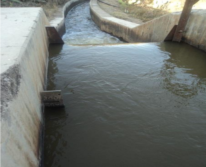
Foto 27. Medidor de volumen de agua para el sistema de riego, en la presa El Girón
