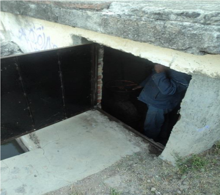
Foto que muestra la válvula giratoria la cual el presero abre y cierra para soltar el agua por el canal. Foto: Noé Téllez Pelcastre.2015.
