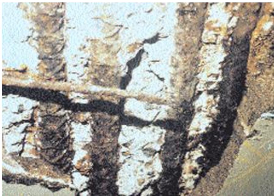
Figura 2.3.3. Daño en el concreto armado a causa de la corrosión en el acero de refuerzo. Fuente: Diseño y Control de Mezclas de Concreto (1992).
