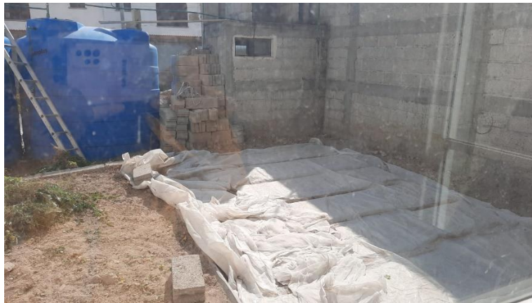
Ilustración 10 Captación de agua
