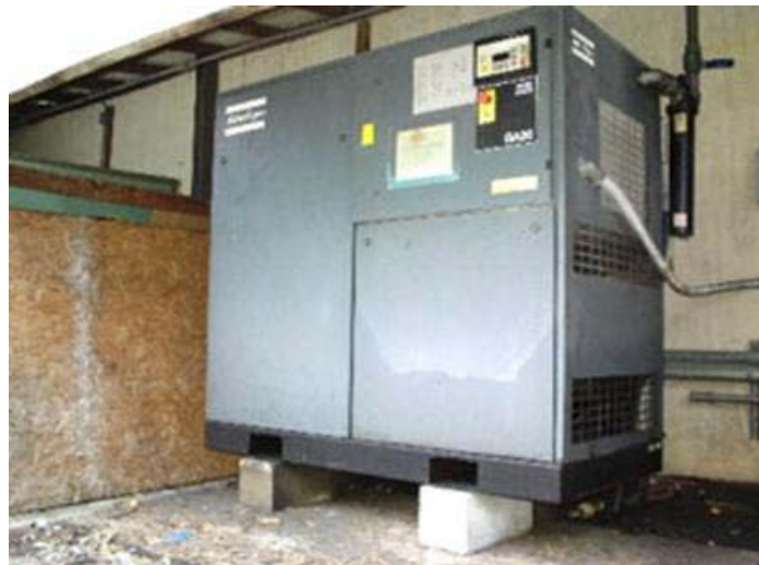
Fig. 1.2.1 Compresor de tornillo rotatorio marca Atlas Copco de 50 HP. [21]
