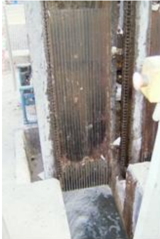
Figura 4.1.2.2.(1). Reja de limpieza mecánica.
