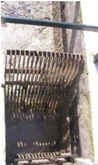
FIGURA 4.1.2.1.(1). REJAS DE LIMPIEZA MANUAL.
