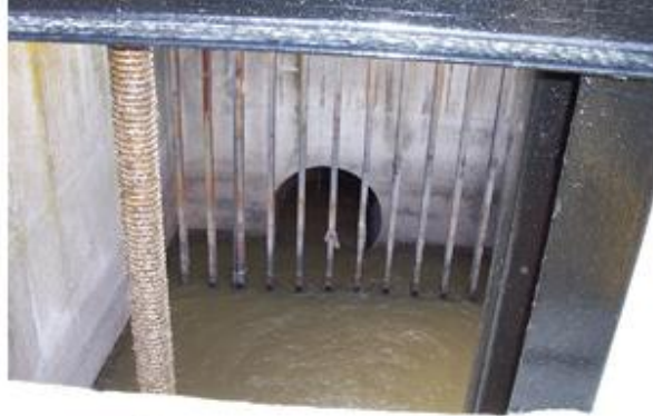
FIGURA 4.1.1.(2). POZO Y REJA DE MUY GRUESOS DE UNA ESTACIÓN DEPURADORA.
