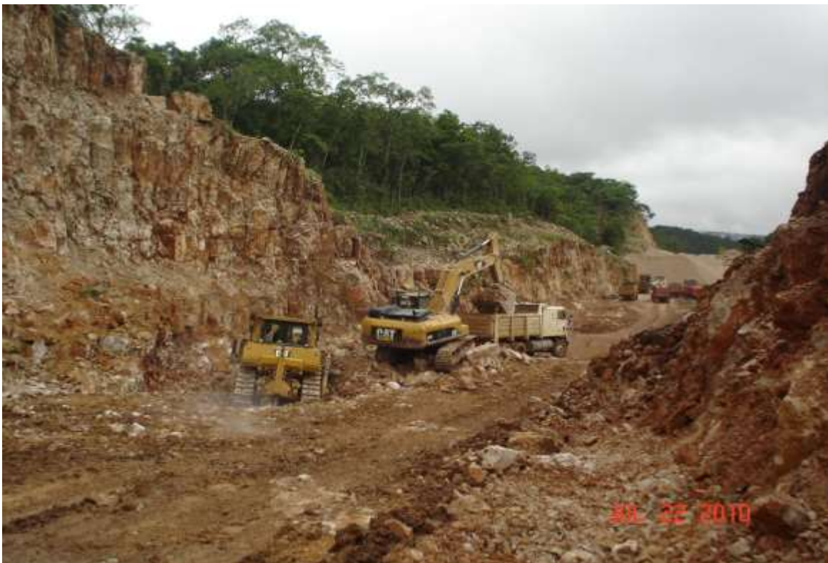
FIGURA 17.- REZAGA DE MATERIAL EN CORTE DEL SUBTRAMO 5.
