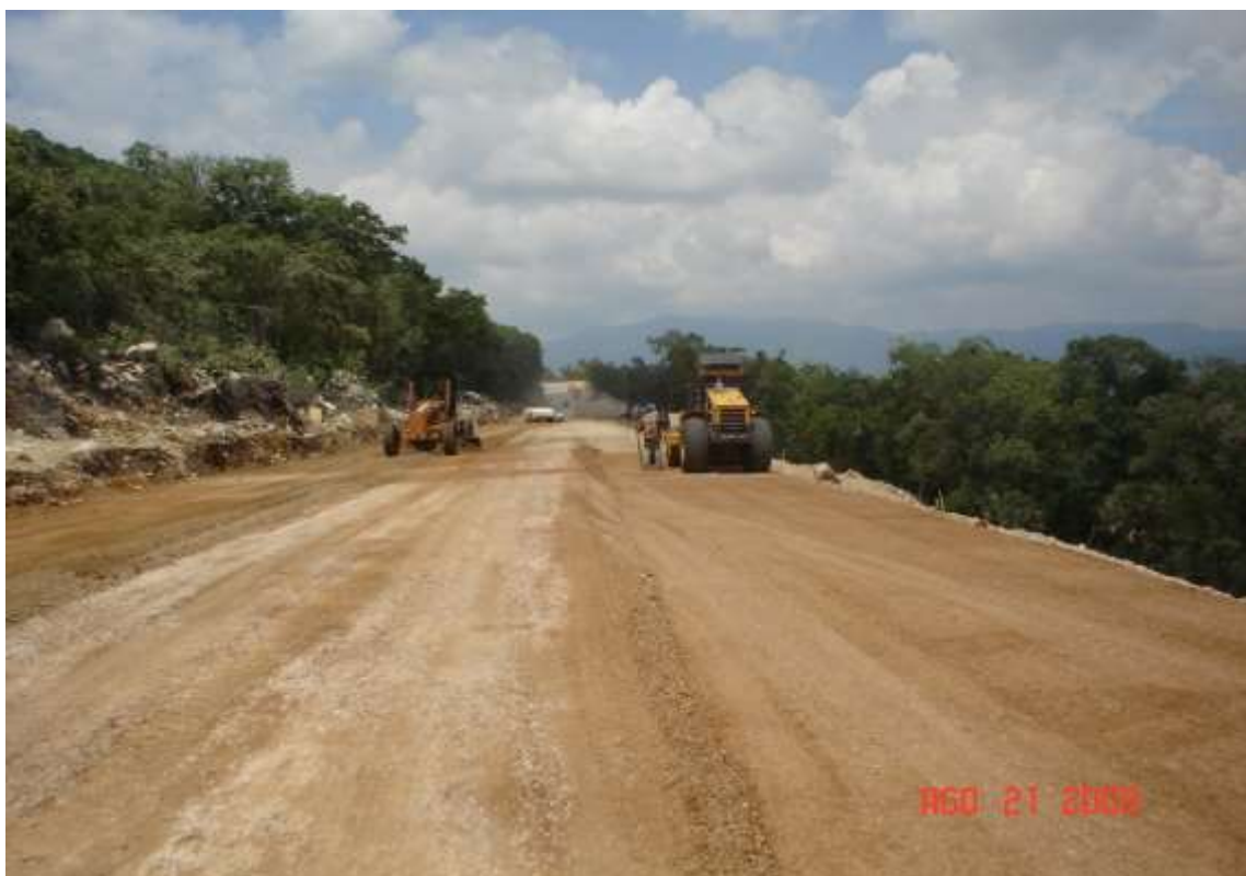
FIGURA 22.- FORMACIÓN DE CAPA SUBYACENTE EN SUBTRAMO 5.
