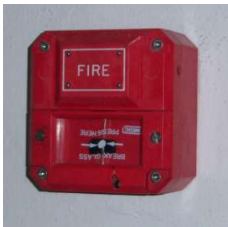
Figura 2.16: Estación manual de alarma
