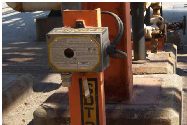
Figura 2.12: Detector de gas tóxico
