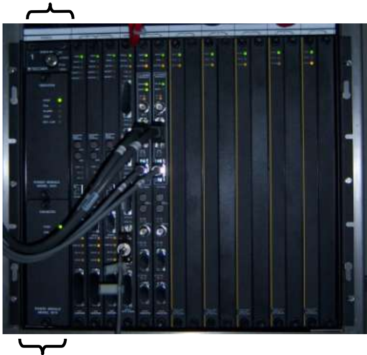
Figura 2.19: Módulo de energía
