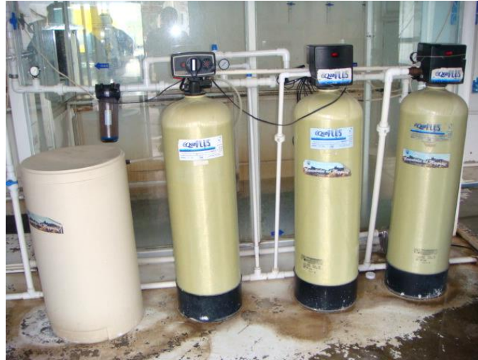
Figura 7 Filtros de purificación del agua.
