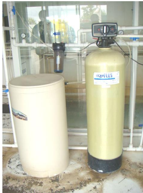
Figura 8 Filtros de purificación del agua y filtros de gravas y arenas.
