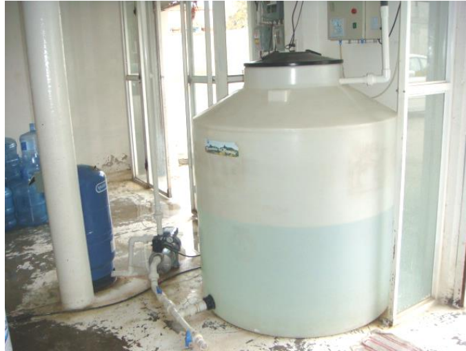
Figura 12 Tanque de almacenamiento
