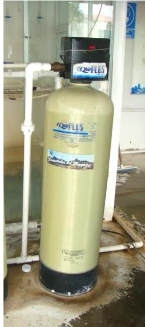
Figura 10 Filtro de resinas
