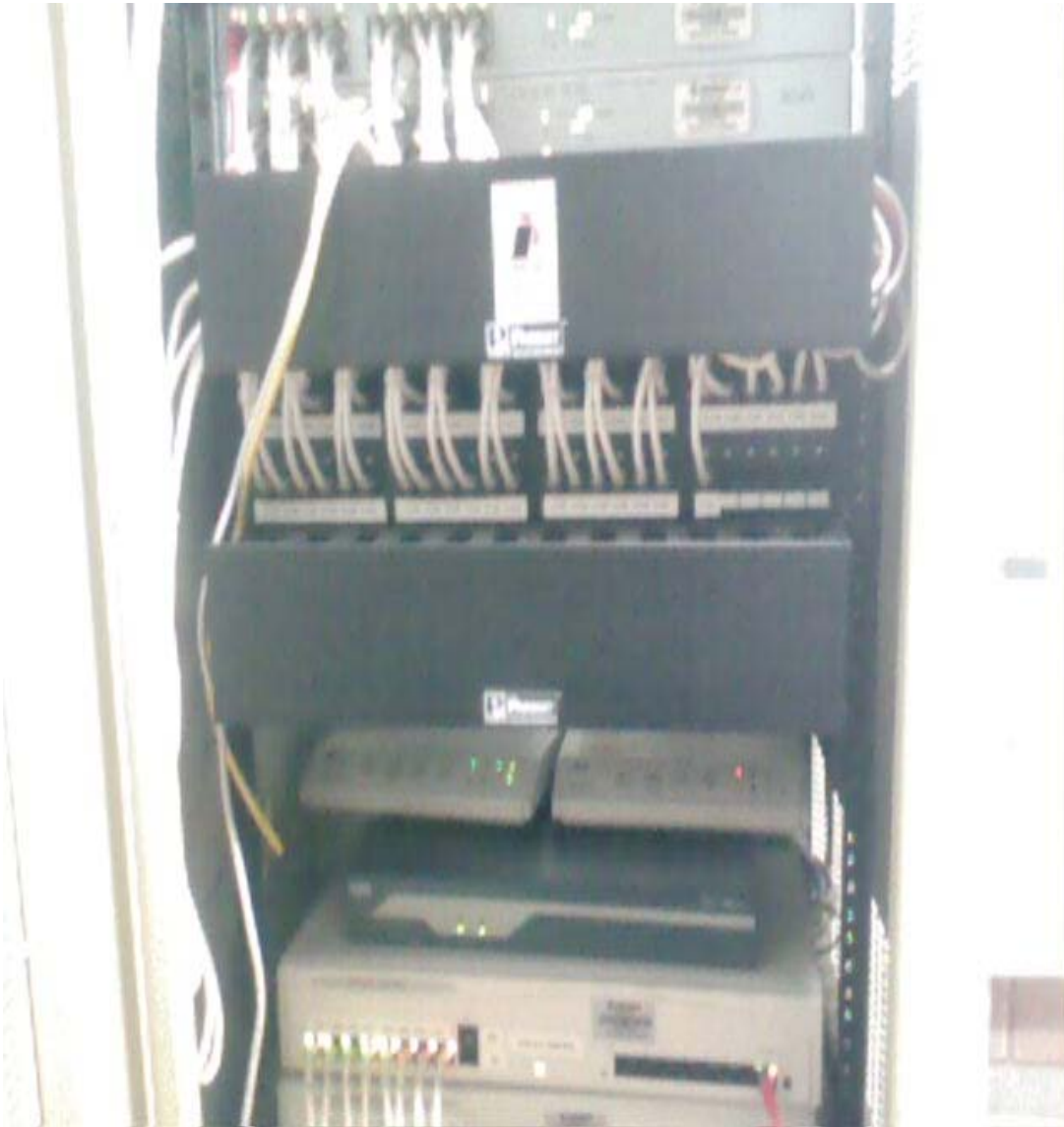
Figura 5.13: Rack A de línea de cajas
