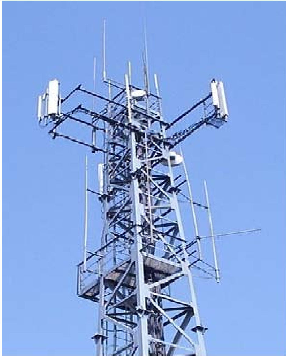
Figura 2.9: Estación base GSM[25]
