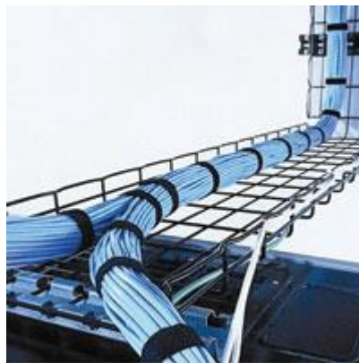
Fig. 6.12 Escalerilla para cableado de datos
