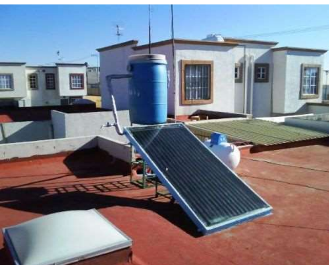
Ilustración 54: Sistema de servicio de agua potable complementario, almacenamiento Fuente: propia
