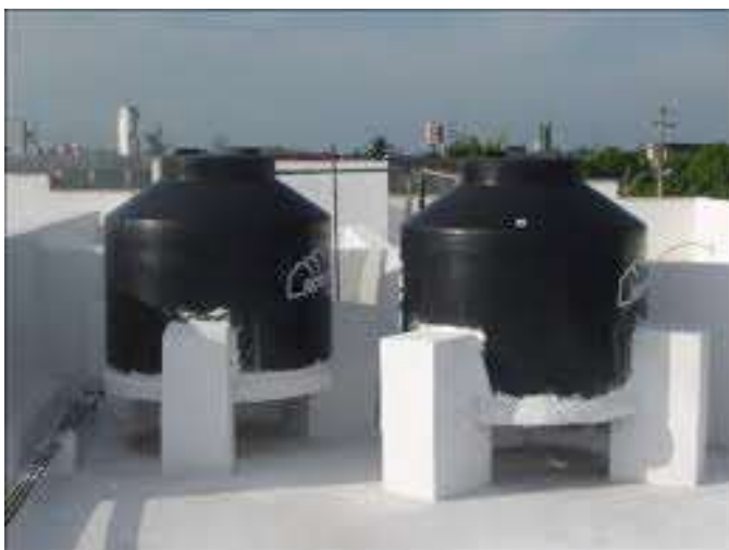
Ilustración 53: Sistema de calentamiento de agua adicional Fuente: Propia
