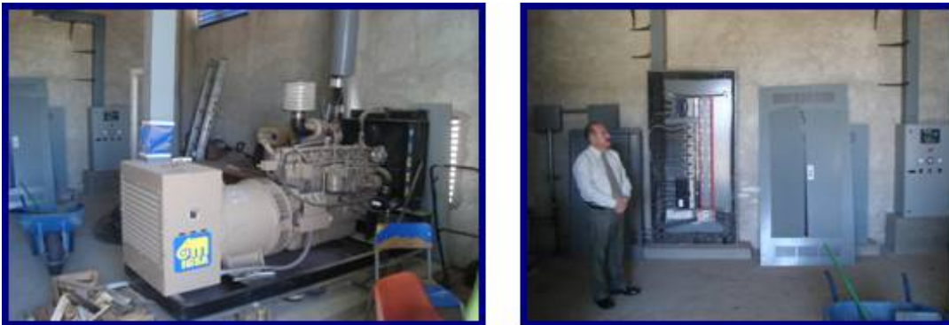
FIG. 3.6 SUBESTACIÓN ELÉCTRICA EN EL INSTITUTO DE CIENCIAS DE LA SALUD.
