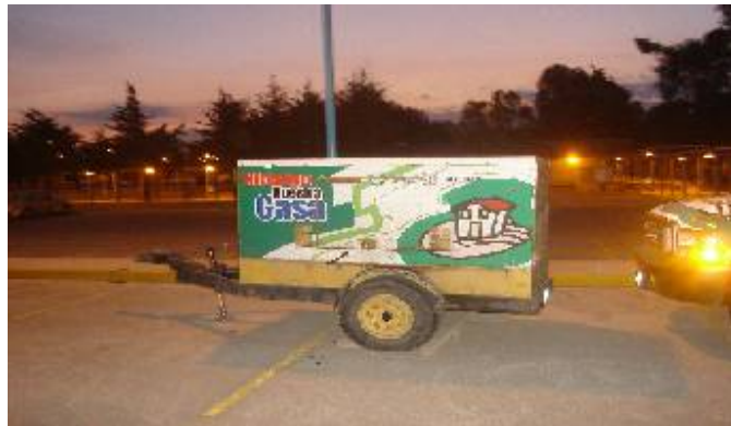
FIG. 3.19 PLANTA ELÉCTRICA DE ALIMENTACIÓN ALTERNA DE LA UNIDAD MÓVIL QUIRÚRGICA
