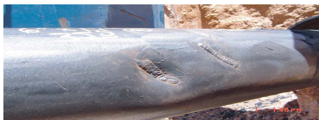
Figura 3.2 Deformación por abolladura Fuente: Comité de normalización de petróleos mexicanos y organismos subsidiarios. Diseño, construcción, inspección y mantenimiento de ductos terrestres para transporte y recolección de hidrocarburos NRF-030-PEMEX-2003
