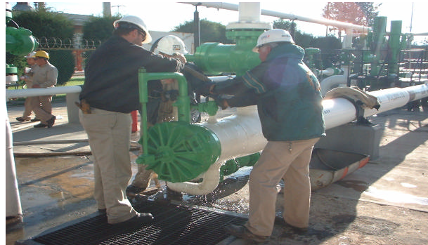
Figura 4.15 Trampa de envío de DIM. Fuente: Foto tomada en instalaciones de PEMEX durante el envío de un DIM (13-06-06)
