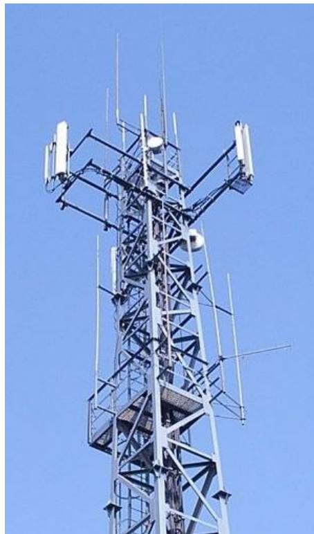
Fig. 1.3 Torre de base GSM
