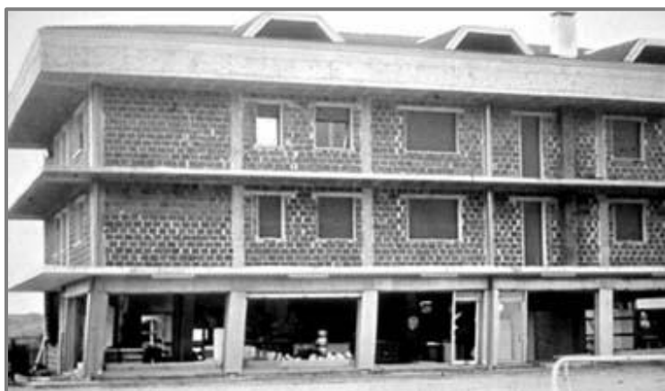
Figura 2.8. Falla en planta baja por piso suave. Fuente: Guevara (1998).
