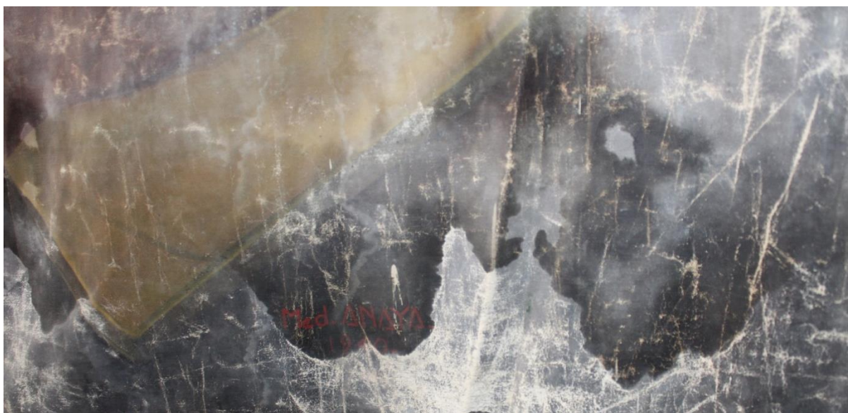
Fig. 14. Detalle IV. Mural sin título [asistencia médica en el ámbito minero] (Anaya). Fragmento inferior: firma del autor integrada en el mural, con deterioro. Foto: Archivo UAEH / Jonathan Stalin Castro, 2025.
