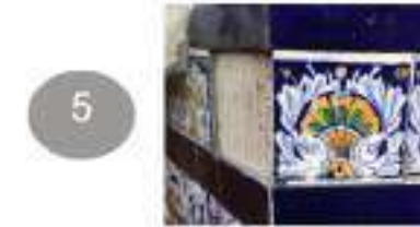
5 Faltantes de piezas en acabados cerámicos: extracción por daño mecánico (golpes principalmente).
