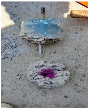
Figura 26. Núcleo de concreto rociado con fenolftaleína.
