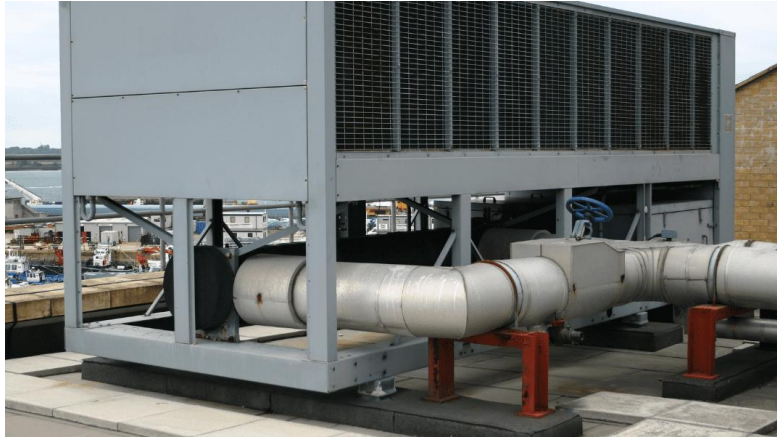
Figura 8. Enfriadores de agua con recuperación de calor. ( enfriadoras , 2022)
