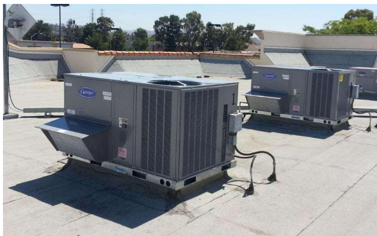
Figura 7. Roof top o equipos en cubierta. ( Heating, ventilation, and air conditioning, 2020)
