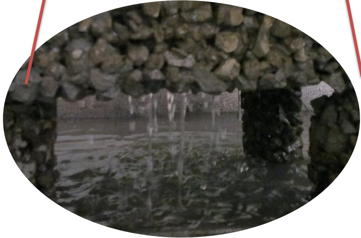
Fig. 3.32 Permeabilidad en losa
