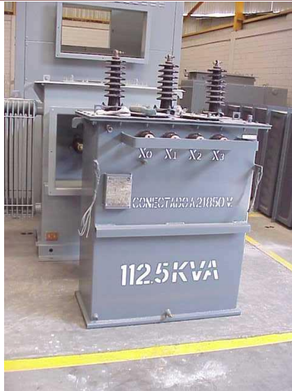
Fig. 2.1 Transformador tipo poste.
