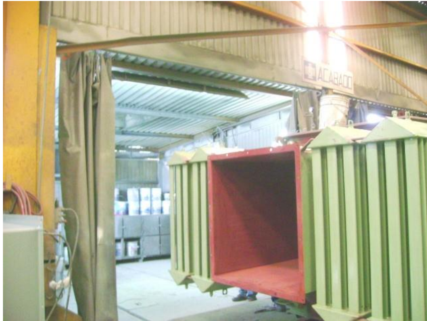
Fig. 3.14 Cámara de pintura
