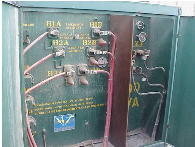
Fig. 2.3 Transformador tipo pedestal.
