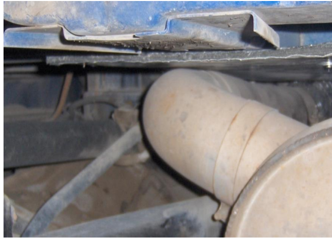
Figura 39. Entrada del codo del silenciador posicionado sin ninguna distancia del aislante térmico
