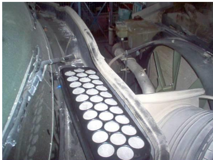
Figura 42. Instalación física del filtro del aire acondicionado y pre filtros.
