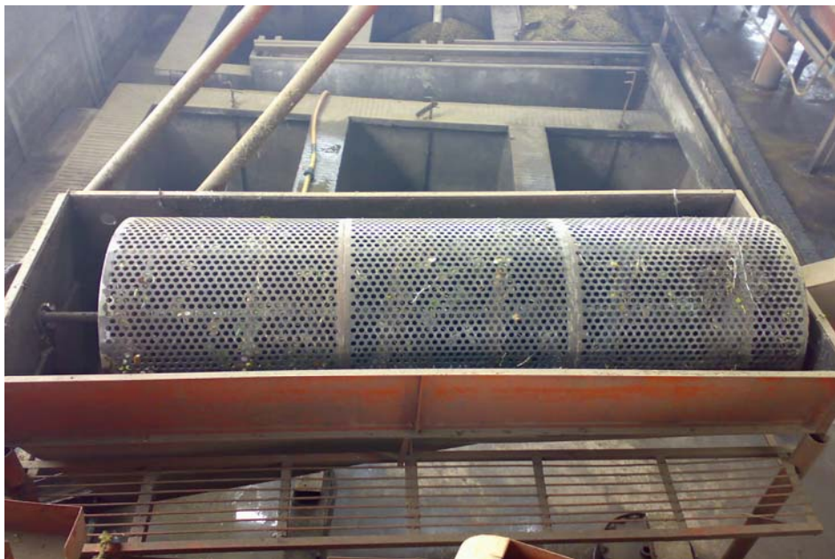
Figura 4.9 .El café llega casi limpio al siguiente modulo gracias a los canales con rejillas.
