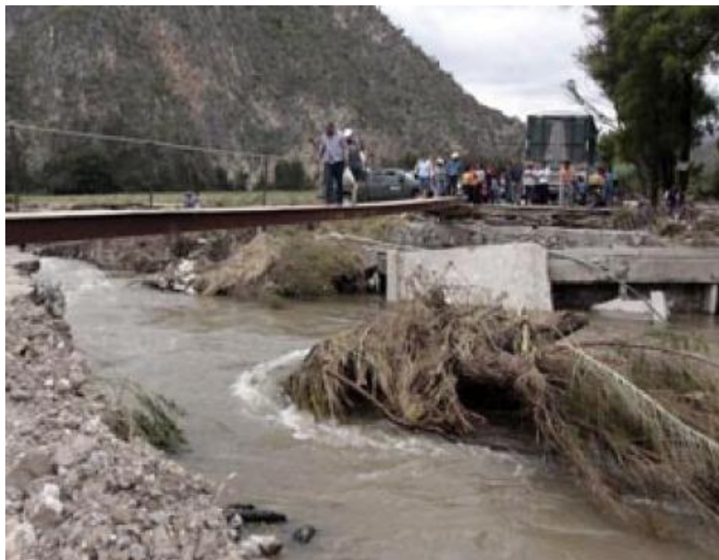
Figura 2.7. Puente de Jihuico destruido por los efectos de la tormenta tropical Arlene en el año 2011. Fuente: http://www.milenio.com/cdb/doc/impreso/9122720
