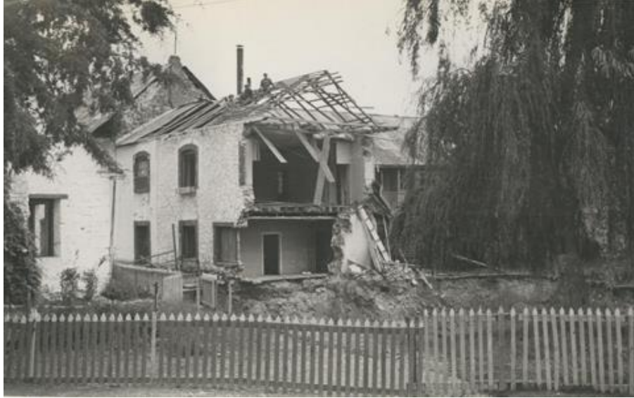
Imagen 13. Interior de San Cayetano. Derrumbe de viviendas. Col. Lic. Juan Randell Badillo. 14/mayo/1964
