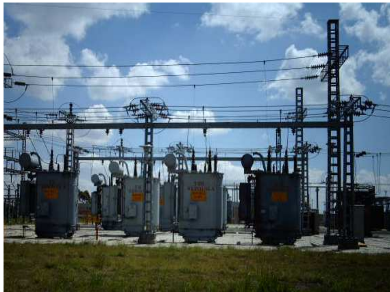
Figura 4.1: Subestación Eléctrica Pachuca.
