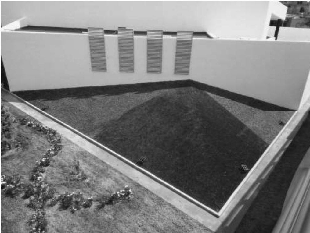
Deterioro ambiental en la sala de arte del jardín del maestro. Elaboración propia.
