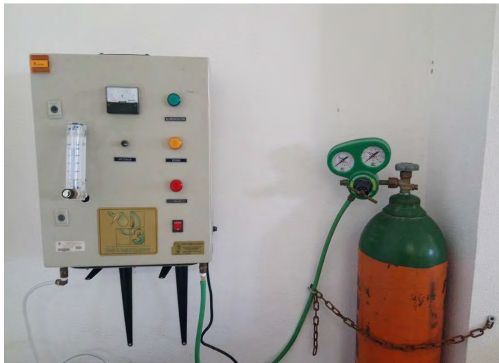
Figura 8.- Generador de ozono de marca Ozone Ecological Equipments, modelo Bio-30 LAB .
