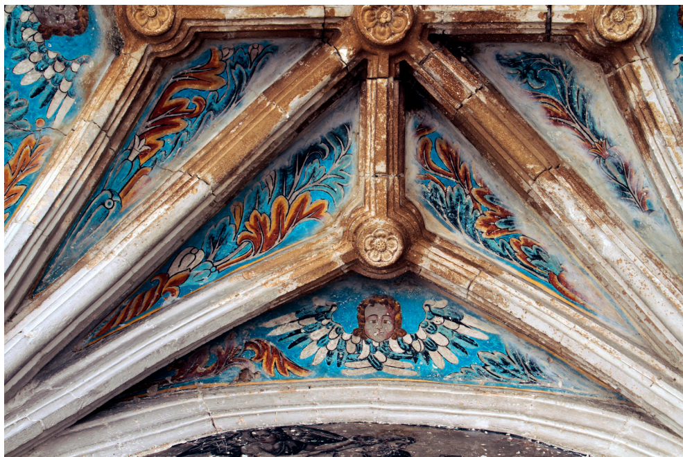
Metztlán: Detalle de las nervaduras que rematan las esquinas de la bóveda del claustro.
