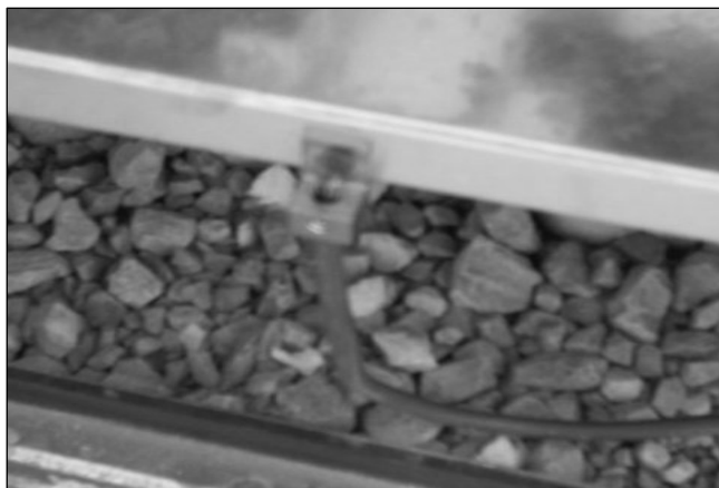
Figura 3.157. Borne de la Conexión a Tierra en C.D.
