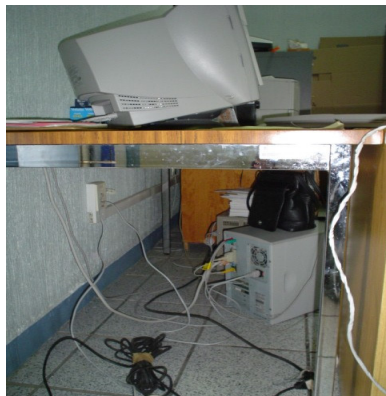
Fotografía 5.4. Riesgos potenciales generados por diferentes aparatos eléctricos.
