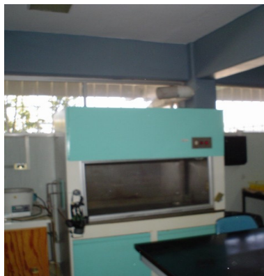
Fotografía 5.5. Riesgo por falta de mantenimiento en la campana de extracción de gases.
