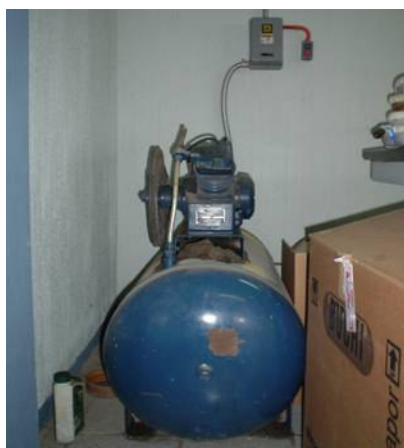
Fotografía 5.8. Compresor ITSA I-2116-HL ubicado en el Laboratorio de Suelos
